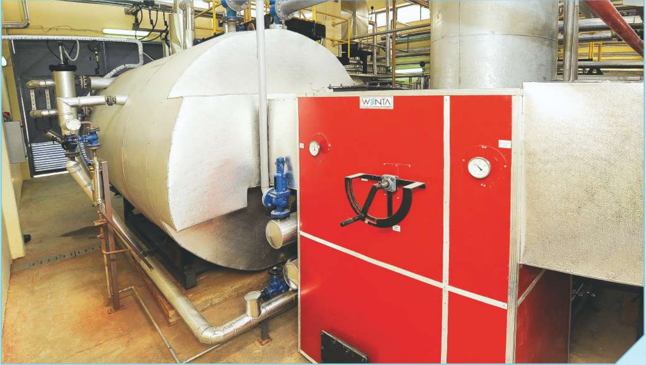
Örnek Ekonomizer yerleşimi ve kurulumu HENKEL Fabrikası/ANKARA 2010. An example of Economizer layout and installation in HENKEL Factory/Ankara 2010.
